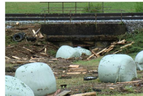
Abb. 3-14: Mit Silageballen und Brennholz verstopfter Durchlass unter der Bahnlinie zwischen Ansbach und Würzburg bei Oberdachsletten (Landkreis Ansbach).
